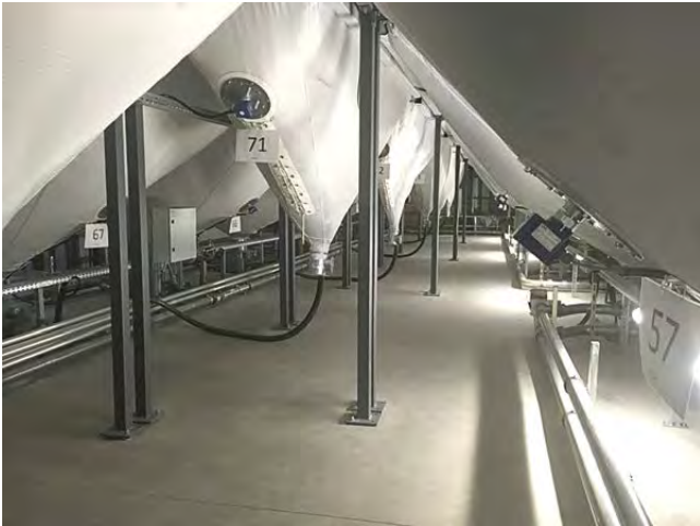
Abb. 32: Durch die Verschaltung mehrerer Fertiglager können große Pelletmengen sicher gelagert werden. Bild: Walter Krause GmbH
