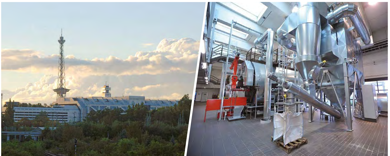
Abb. 2: Ein Pelletkessel trägt zu großen Teilen zum nachhaltigen Wärmekonzept der Messe Berlin bei. Bild: GETEC heat & power GmbH
